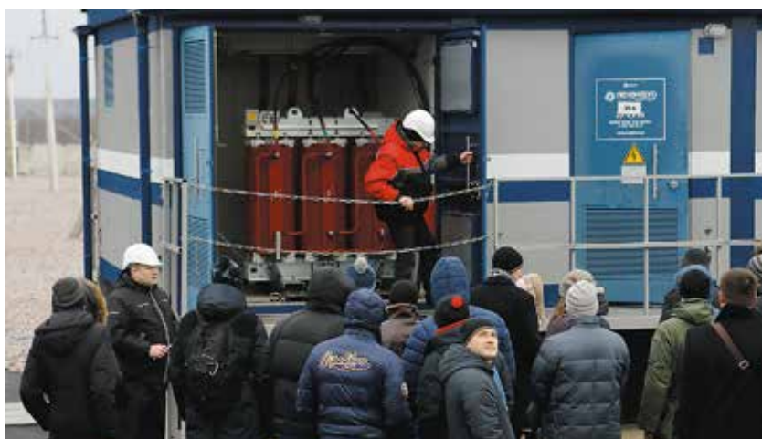
Студенты энергетических вузов Петербурга побывали на экскурсии по учебно-тренировочному полигону «Ленэнерго» в Терволово. Они ознакомились с оборудованием комплексов высоковольтных и распределительных сетей с опорами различного исполнения.
