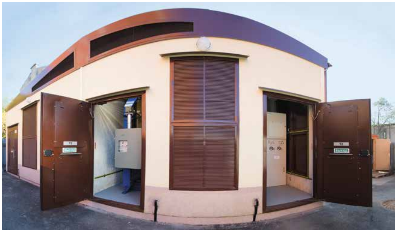
«Ленэнерго» развивает сеть 35 кВ в Петроградском районе Петербурга. Энергетики установили здесь две модульные комплектные трансформаторные подстанции 35/6 кВ
