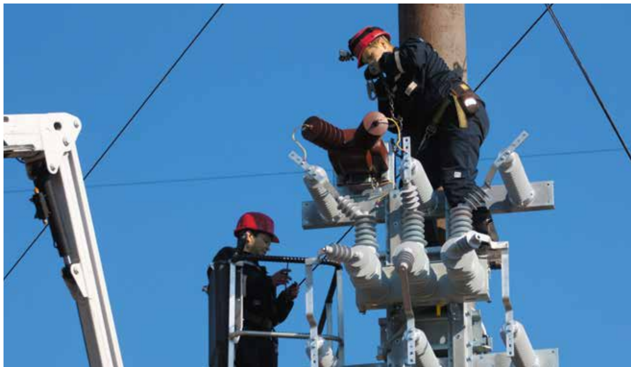
Общая протяженность воздушных линий 35 кВ в Петербурге и Ленобласти – больше 4 тысяч километров
